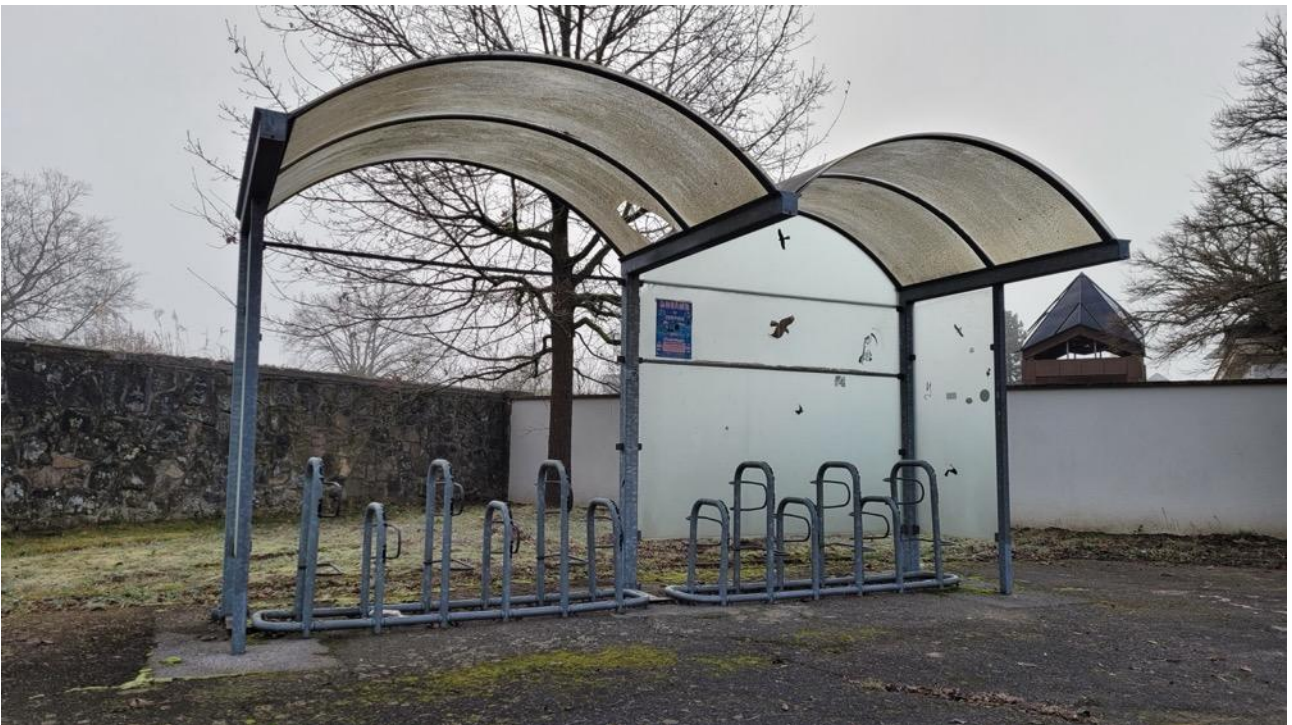
Am Friedhof Heusenstamm fehlt die eine Rückwand, das Dach hat ein Loch. Ein Schmuckstück? Immerhin gibt es Bügel.
