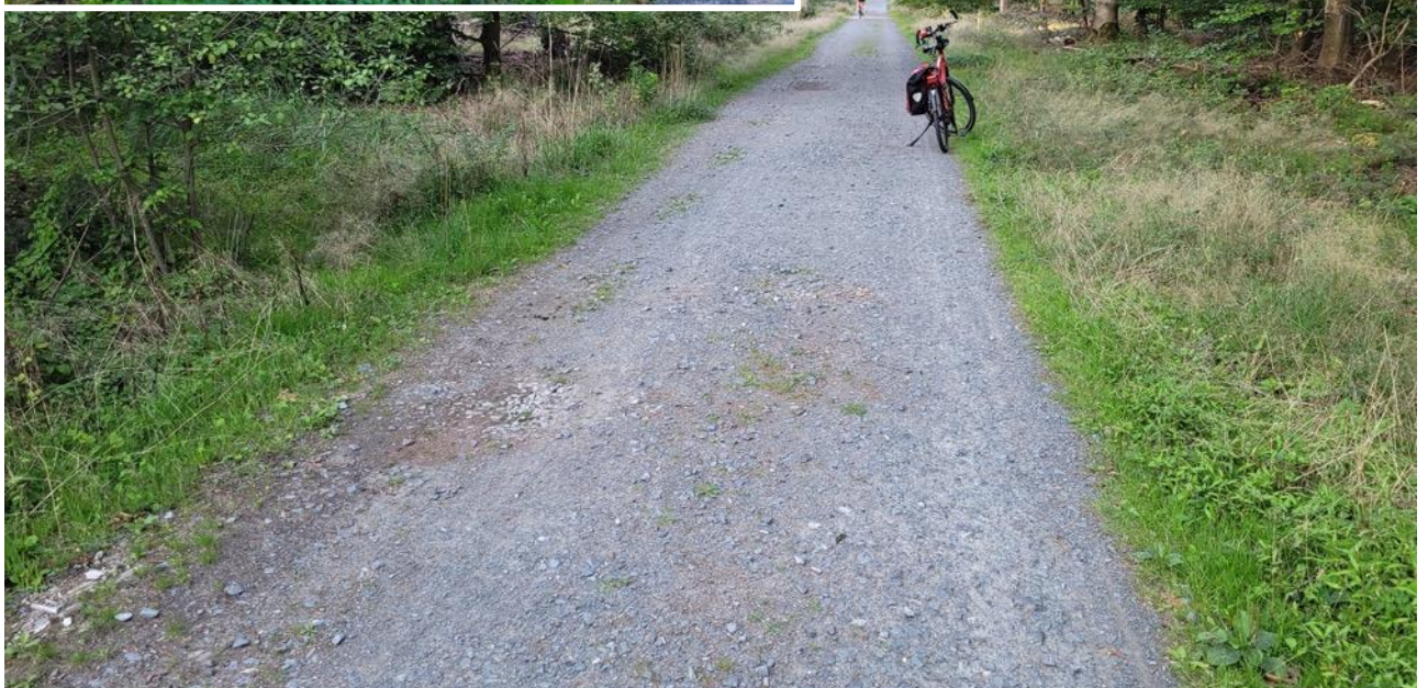
Hier fehlt eine Feinkiesdeckschicht.
